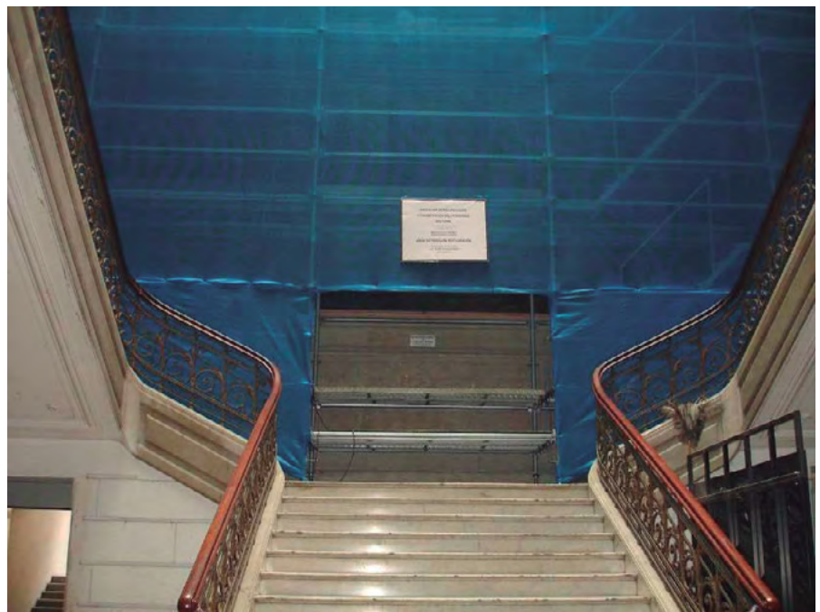
Figura N° 1a y 1b. Inicio de obra, armado del andamio en la escalera del hall central. Fuente: Todas las fotos son del autor.
